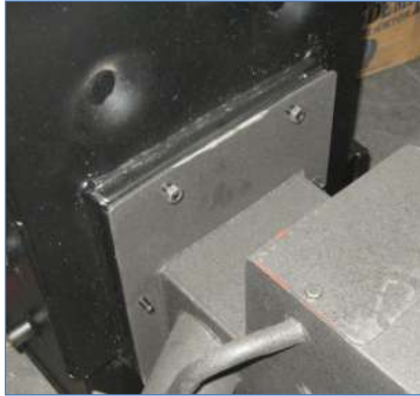
Малюнок 31. Встановлений на котлі корпус шнекової подачі.
